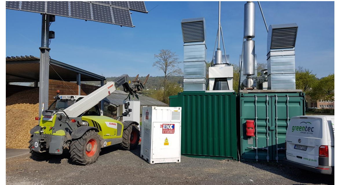
Einbindung inselnetzfähiges BHKW im hessischen Biogas-Forschungszentrum, Bad Hersfeld-Eichhof
