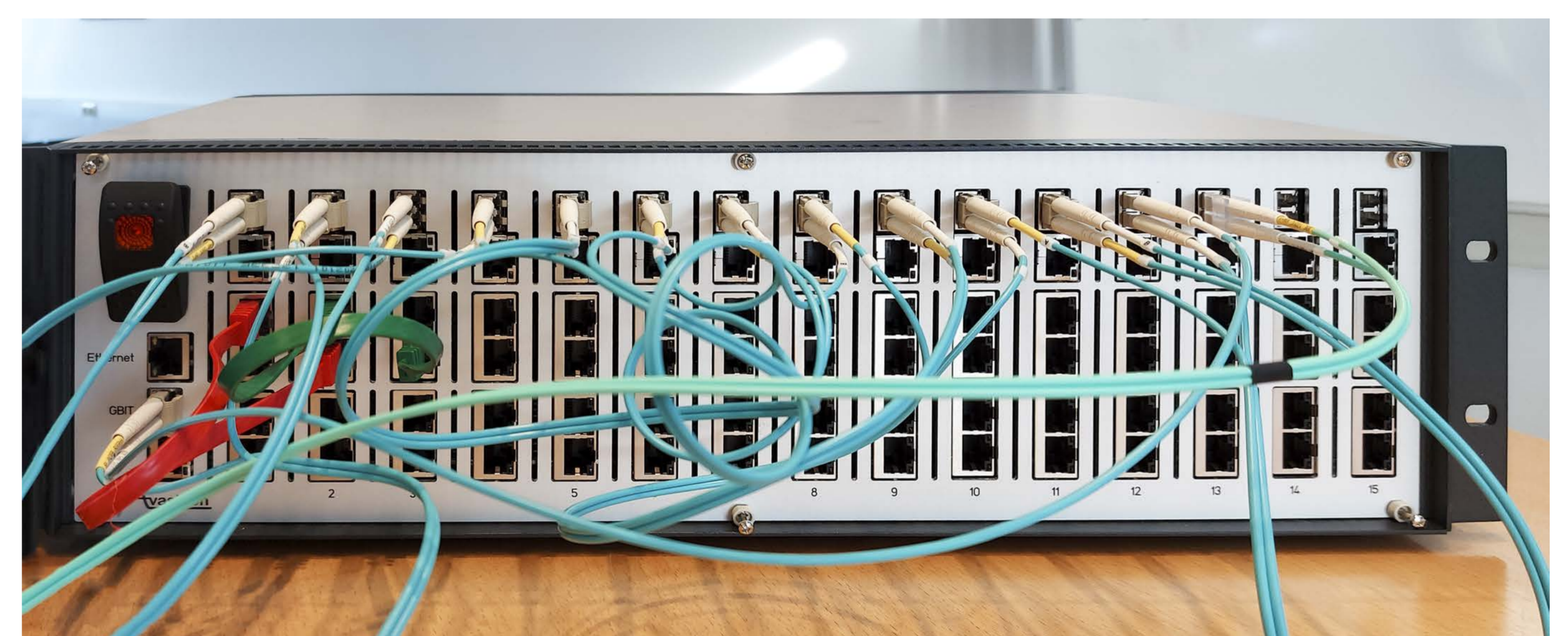
Ein Rack mit 15 unabhängigen Recheneinheiten.
