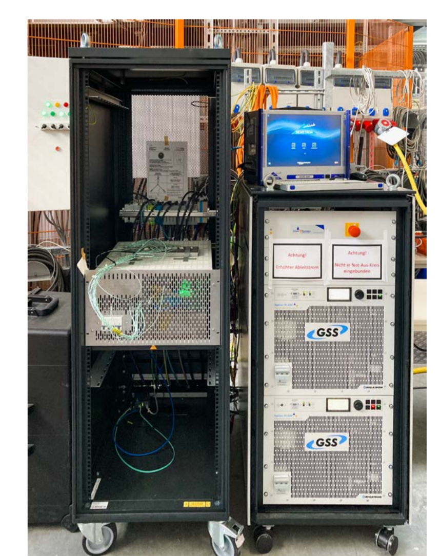
Prototyp eines netzbildenden Stromrichters (links) und steuerbare DC-Versorgung (rechts)
