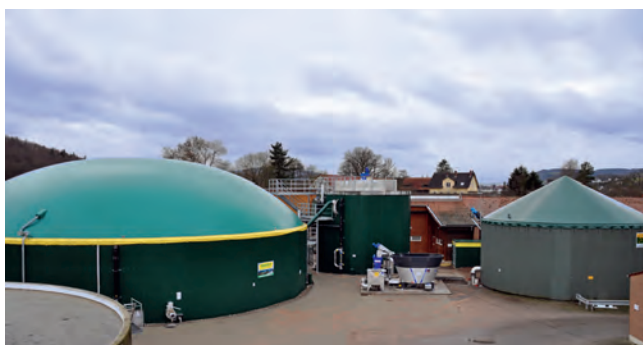
Neue Forschungsbiogasanlage im HBFZ für die bedarfsgerechte Stromproduktion.
